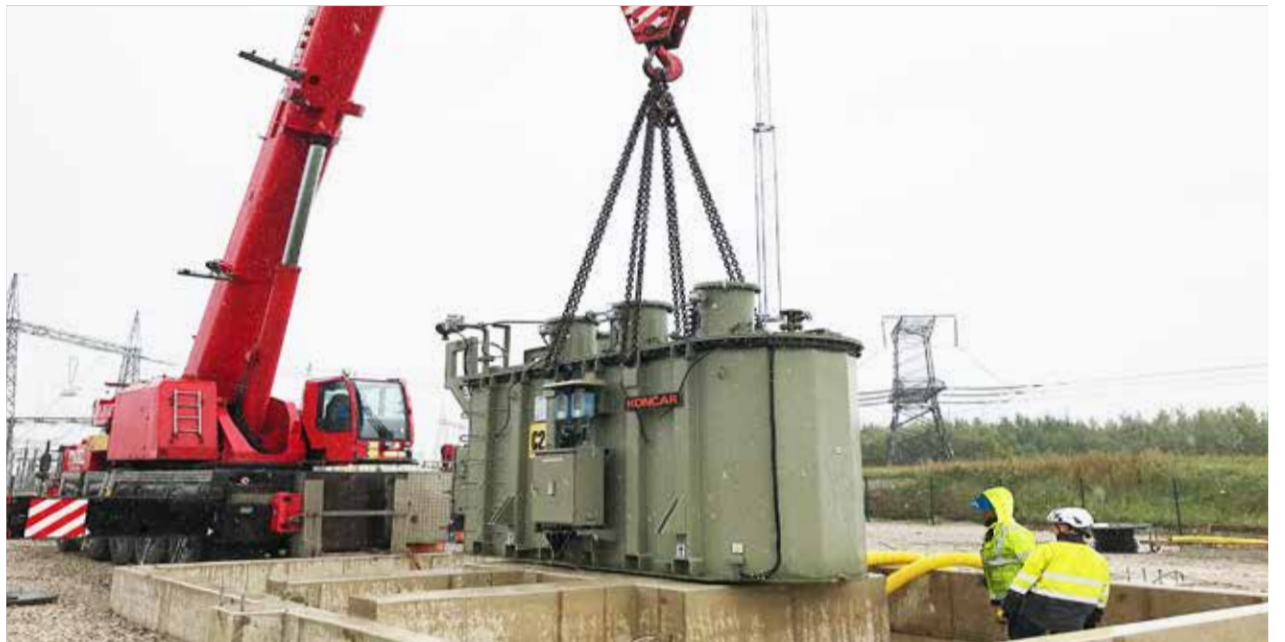
14.09.2017 sai paika Ühistu tuulepargi alajaama keskpunkt - trafo. Tule 14. oktoobril 2017 kella 12-ks Püssi linna Olerexi tankla juurde. Sealt läheme ühiselt Ühistu rajatavat tuuleparki vaatama ja näpuga katsuma. Logistika ja registreerimine: triin.roos@yhistupank.ee või tel. 5622 1186
